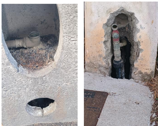
Figura-5: Bocas de incêndio inoperacionais ou mal mantidas. Fotos tiradas na estrada entre Vaqueirinho e Talasnal (foto do lado esquerdo) e no depósito de água do Talasnal (foto do lado direito).
